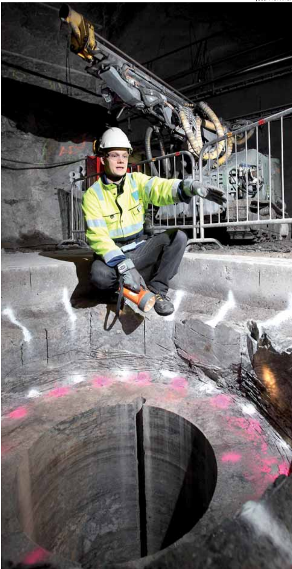
Posivan kehitysinsinöörin Pasi Rantamäen edessä on reikä, jossa Posiva tekee käytännön bentoniittikoetta. Reikään asennettavan metallikapselin ympärille laitetaan bentoniittipuskuri. Koe kestää ainakin kaksi vuotta.
