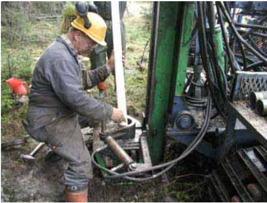
Olkiluotoon asennettiin syksyllä 2001 kahdeksaan paikkaan yhteensä 16 siiviläputkea maapeitteeseen liittyvien hydrologisten ja kemiallisten ilmiöiden tutkimiseksi.
