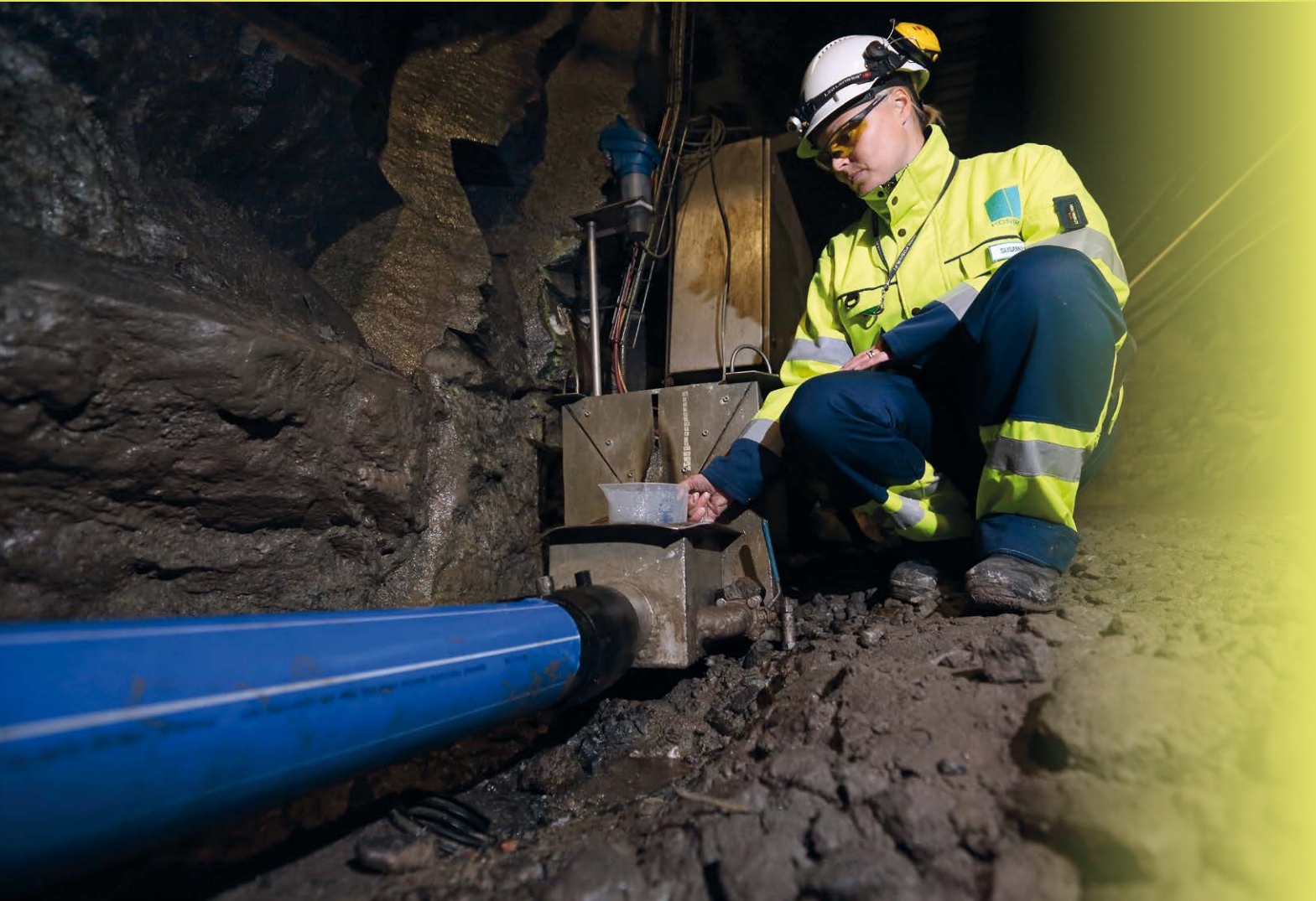
ONKALOon vuotavan kalliopohjaveden määrää ja laatua seurataan säännöllisesti.
